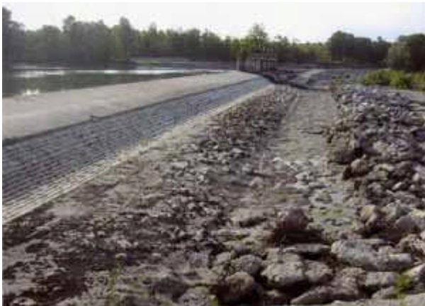
Fiume Adda in condizioni di carenza idrica l'acqua superficiale viene totalmente derivata dal canale Vacchelli
